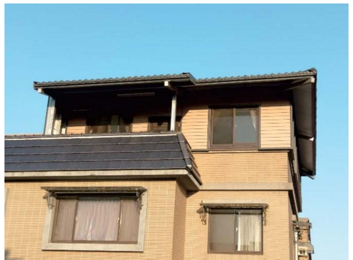
台灣普遍存在的屋頂增建工程及風災危害
